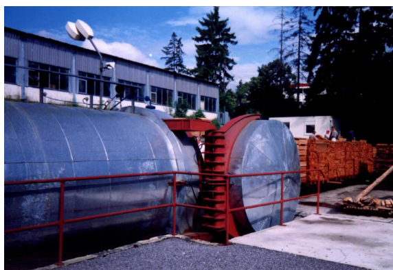
Рис. 2. Общий вид автоклава, используемого для пропарки пиломатериалов в Sundermann s.r.o. в г. Banska Stiavnica (Словакия)
